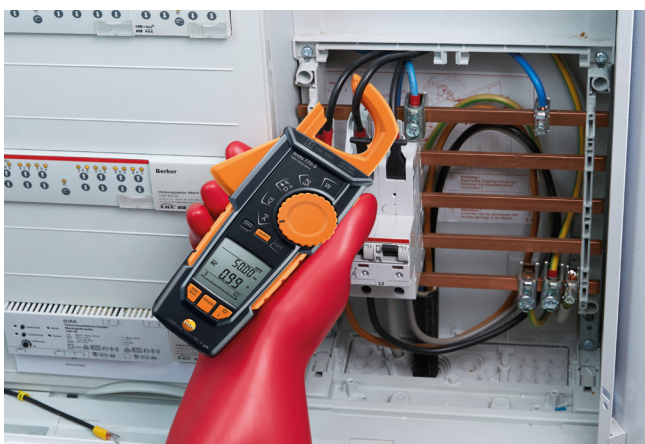
Strommessung am Schaltschrank.
