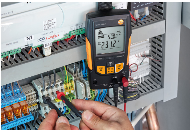
Spannungsprüfung am Schaltfeld einer Wärmepumpe.
