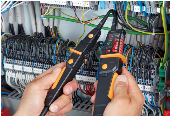
Spannungsmessung im Schaltschrank.
