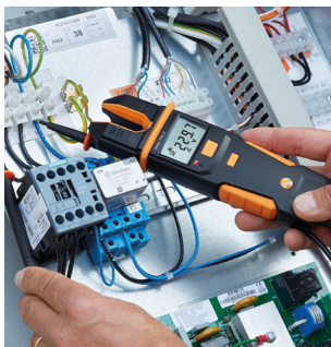
Spannungsmessung an einem Verdichter.
